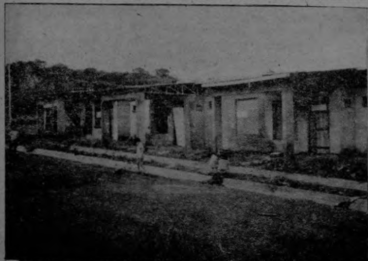
Casas medio destruidas por el abandono de Constructoras Urbanística Empresarial S.A.
